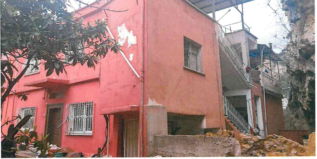
Foto 1. Ahmet, Sedat ve Sinan GELMEZ'e ait kaya düşmesinden etkilenmesi muhtemel konut
